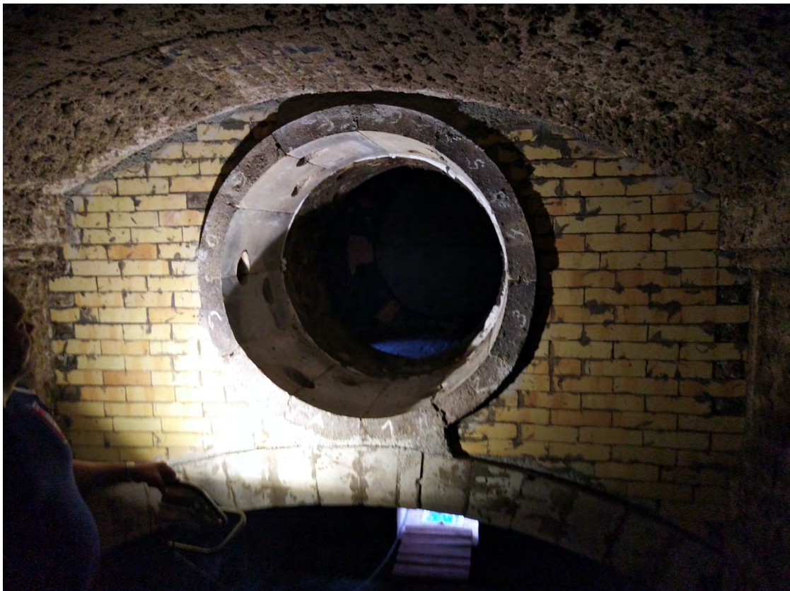
Rökgaskanalen i större biobrännlepannan, med tertiärlufthålen synliga i kanalväggen
