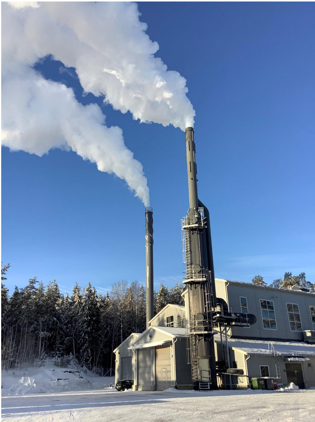
Molemmat biolämpökattilat käynnissä. Talvella syntyy runsaasti vesihöyryä.
