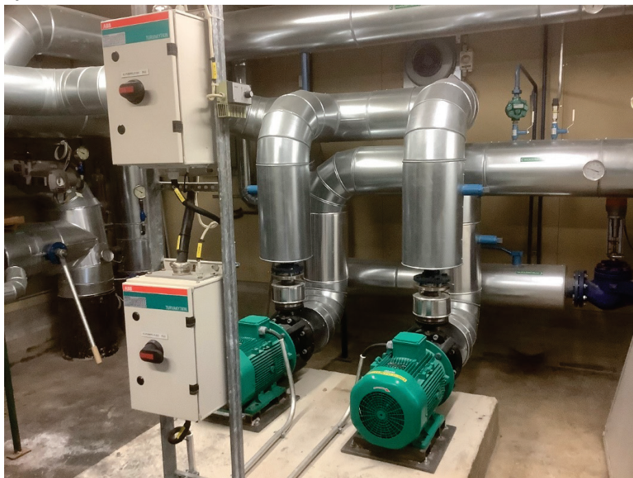
Fjärrvärmepumpar i Finnsementtis värmeväxlarutrymme.
