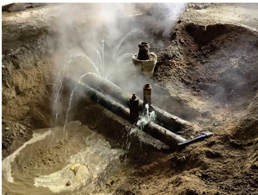
Läckage på fjärrvärmenätet vid Strandvägen som åtgärdades snabbt.
